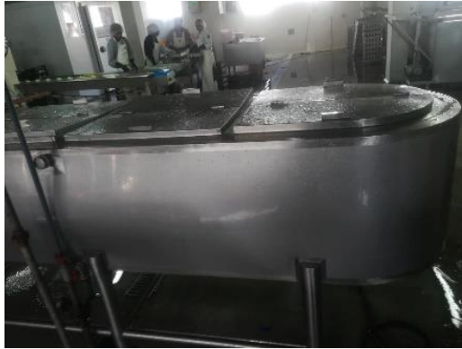
Imagen 6: Tanque de almacenamiento
