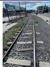
Fotografía 4. Deterioro de líneas ferreas.
