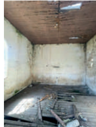
Fotografía 4. Deformaciones Desgaste / desprendimiento
