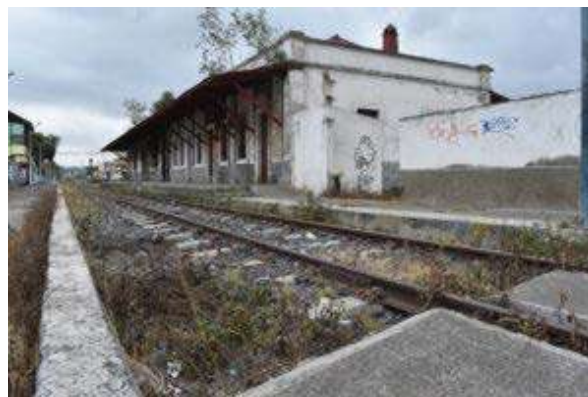
Nota. Estación del Cantón Salcedo abandonada con rastros de vandalismo.
