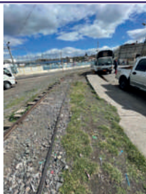
Fotografía 2. Pérdida de durmientes y línea férrea.
