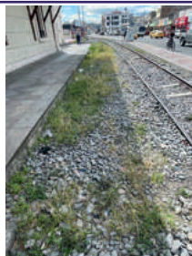
Fotografía 3. Falta de mantenimiento, crecimiento de maleza.
