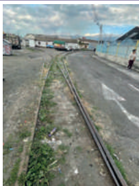
Fotografía 1. Robo de durmientes y parte de la línea férrea
