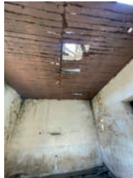
Fotografía 2. Algas - liquenes Deformaciones
