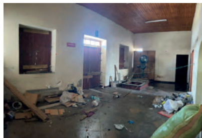
Fotografía 3. Antropopico - Desgaste - Humedad
