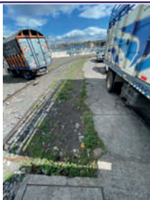
Fotografía 1. Deterioro de Aceras y reducción del espacio de circulación
