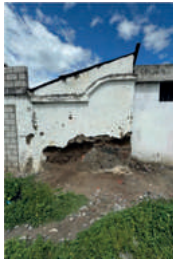
Fotografía 1. Grieta en muro
