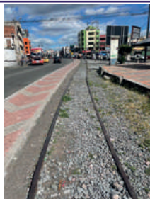
Fotografía 1. Robo de durmientes.
