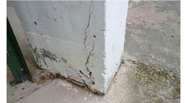
Figura 1. Fisuras en la estructura de hormigón Fuente: (Jiménez. 2020).
