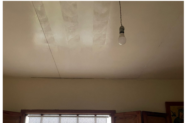
Figura 81. Estado actual de la cubierta inclinada por el interior de la vivienda de 1980 (cod. v.10)
