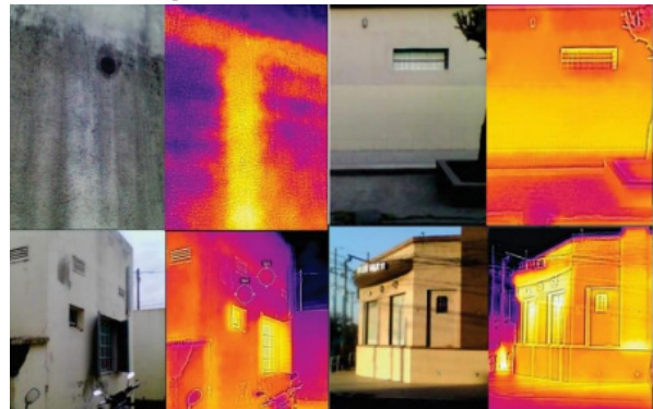
Figura 6. Detección de puentes térmicos
