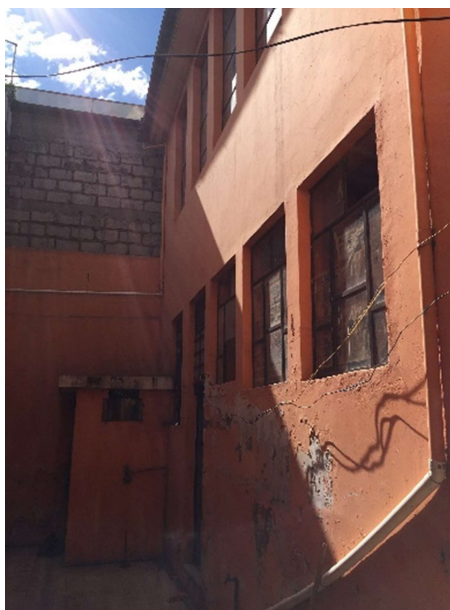
Fotografía 3 Estado de la pintura deteriorada
