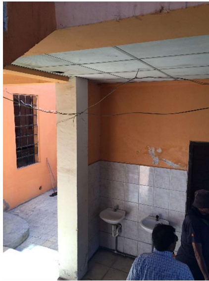
Fotografía 2 Baños improvisados y mal ubicados
