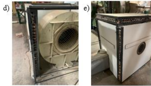
Figura 18: Implementación de la cámara acústica.
