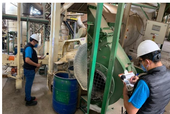
Figura 29: Toma de datos ruido del ventilador M350.
