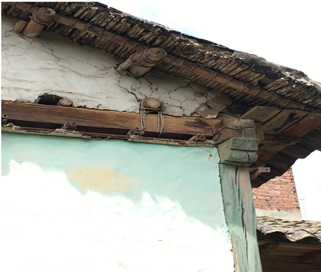
Figura 23. Patologías presentes en la cubierta de la Casona Universitaria-UTI.
