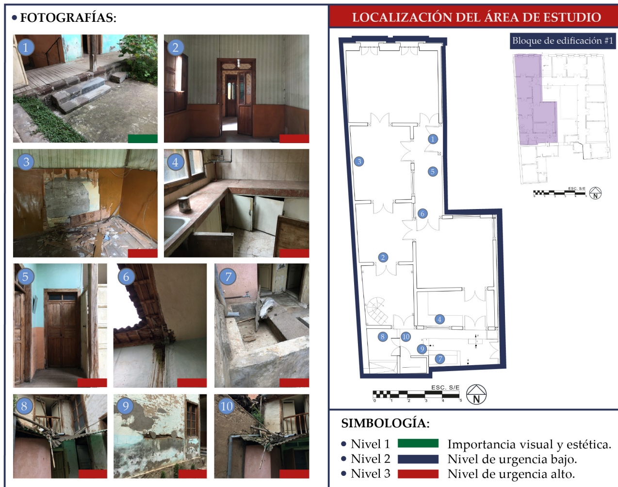
Figura 26. Patologías referentes al bloque 1 de edificación de la Casona Universitaria-UTI.
