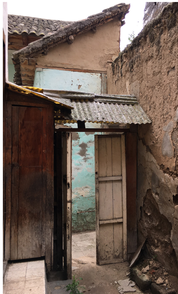
Figura 24. Patologías en muros y carpinterías vistas desde la cocina de la Casona Universitaria-UTI.
