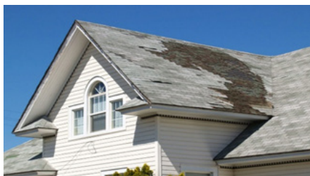
Figura 13. Desgaste en cubiertas
