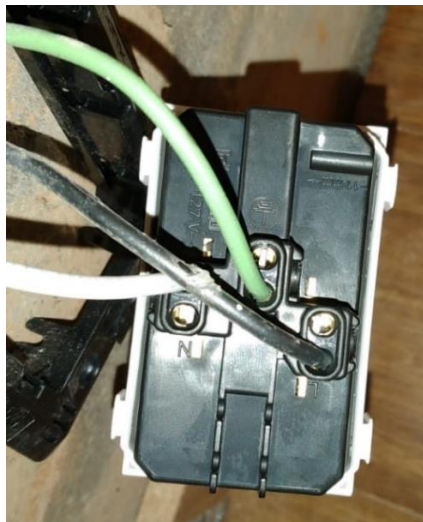
Ilustración 9. Tomacorrientes y conectores Elaborado por: Palacios (2022)
