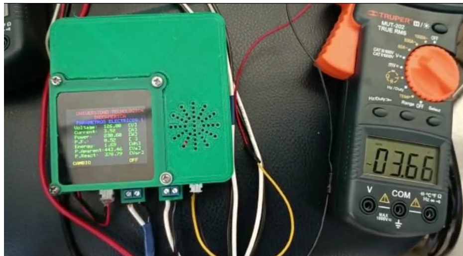
Figura 52-3. Medición de corriente del motor 2
