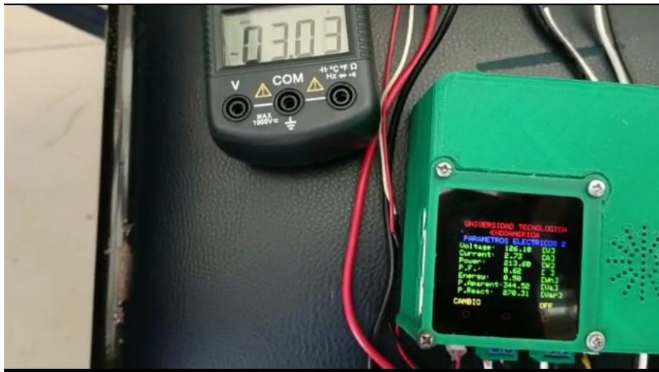
Figura 51-3. Medición de corriente del motor 1
