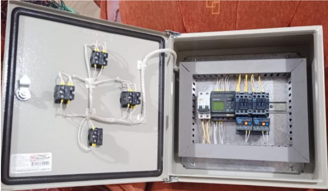
Imagen 9. Parte interna del tablero. Elaborado por: Luis Mejía Fiallos, (2022).
