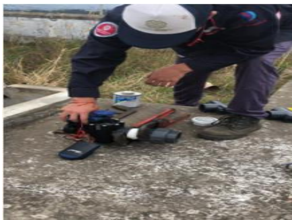
Imagen 19. Adaptación de tuberías con electroválvulas. Elaborado por: Luis Mejía Fiallos, (2022).
