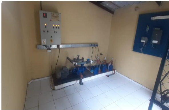
Imagen 6. Sistema de bombeo. Elaborado por: Luis Mejía Fiallos, (2022).
