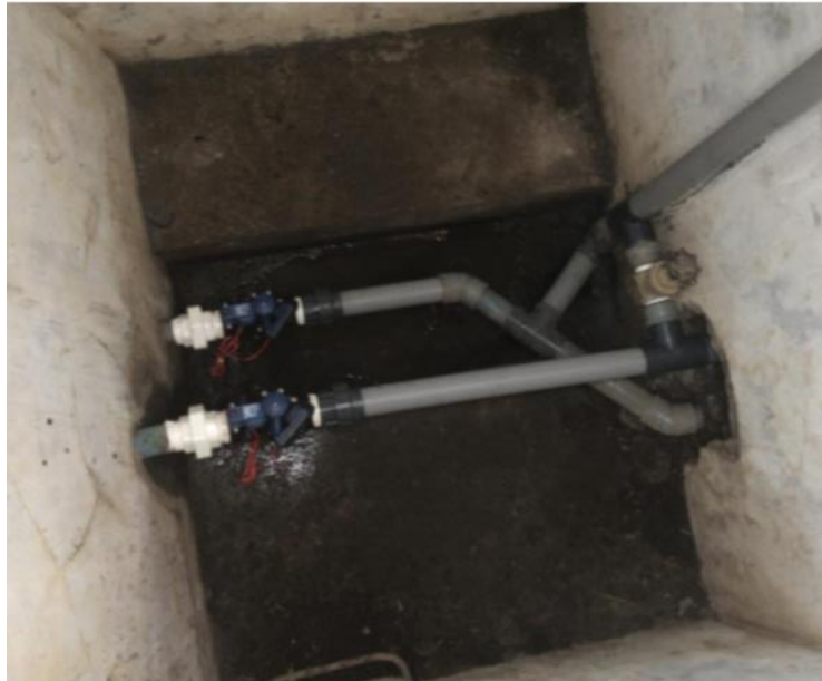
Imagen 20. Conexión de la tubería con la llave de emergencia. Elaborado por: Luis Mejía Fiallos, (2022).
