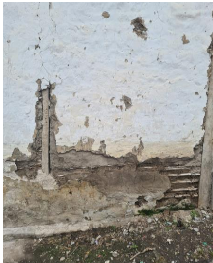
Figura 60. Deterioros en muros
