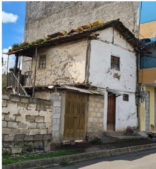
Figura 50. Deterioro en fachadas
