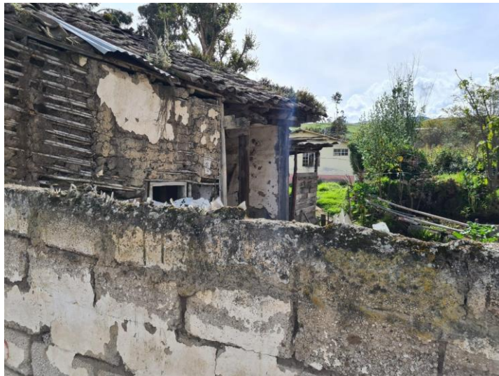
Figura 42. Deterioro en muros
