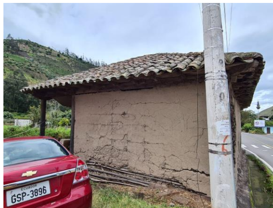
Figura 17. Deterioro en fachada
