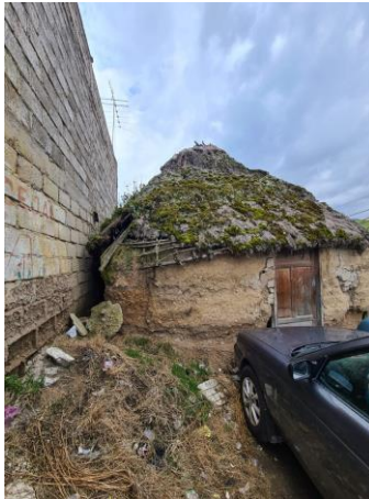
Figura 33. Deterioro en fachadas
