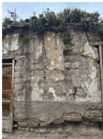
Figura 74. Deterioros en muros
