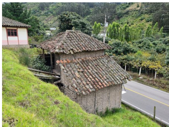
Figura 26. Deterioro en cubierta
