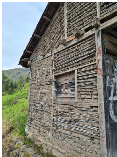
Figura 24. Deterioro en fachadas
