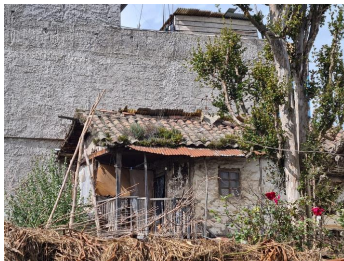
Figura 51. Deterioro en cubierta
