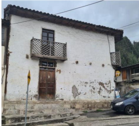
Figura 59. Deterioro en fachada
