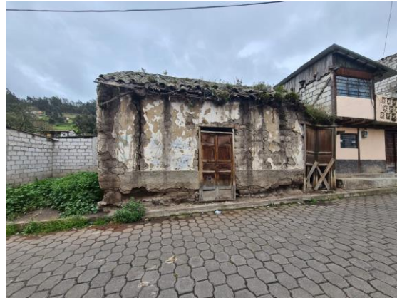
Figura 73. Deterioro en fachada
