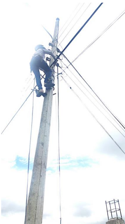
Ilustración 148: Verificación de ausencia de energía Elaborado por: Jonathan Jara
