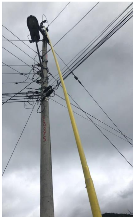
Ilustración 136: Desconexión del seccionador Elaborado por: Jonathan Jara
