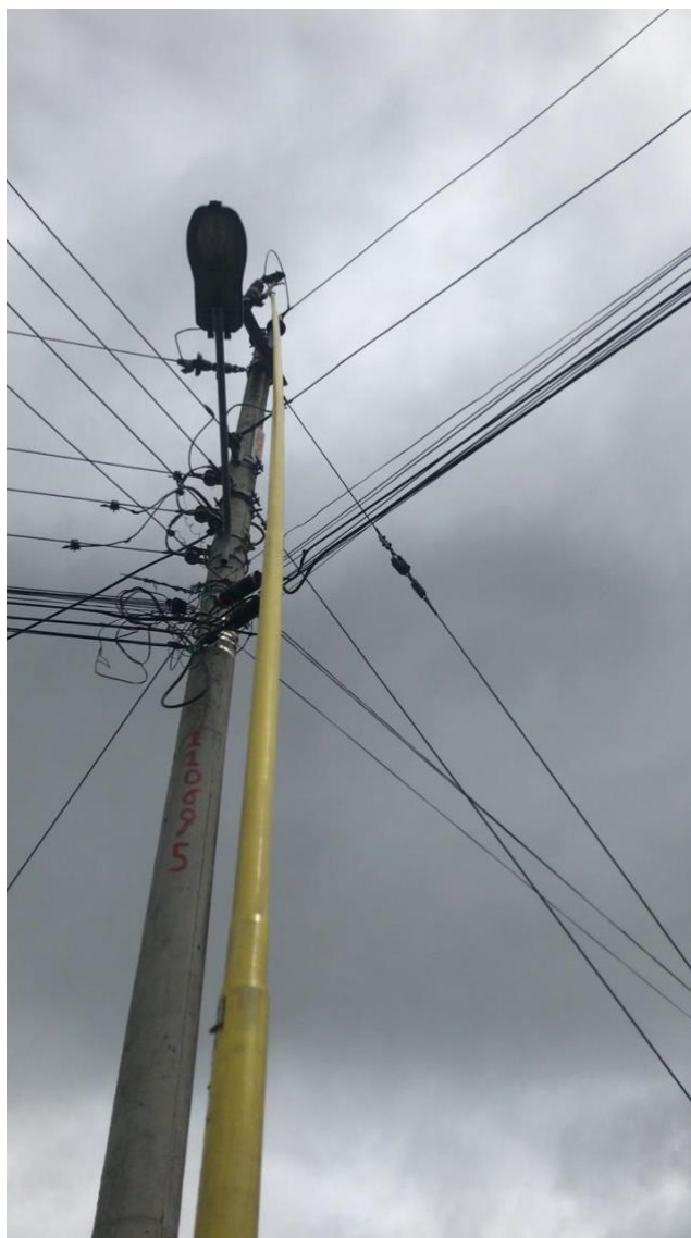
Ilustración 175: Conexión del seccionador para restablecer el servicio eléctrico Elaborado por: Jonathan Lara
