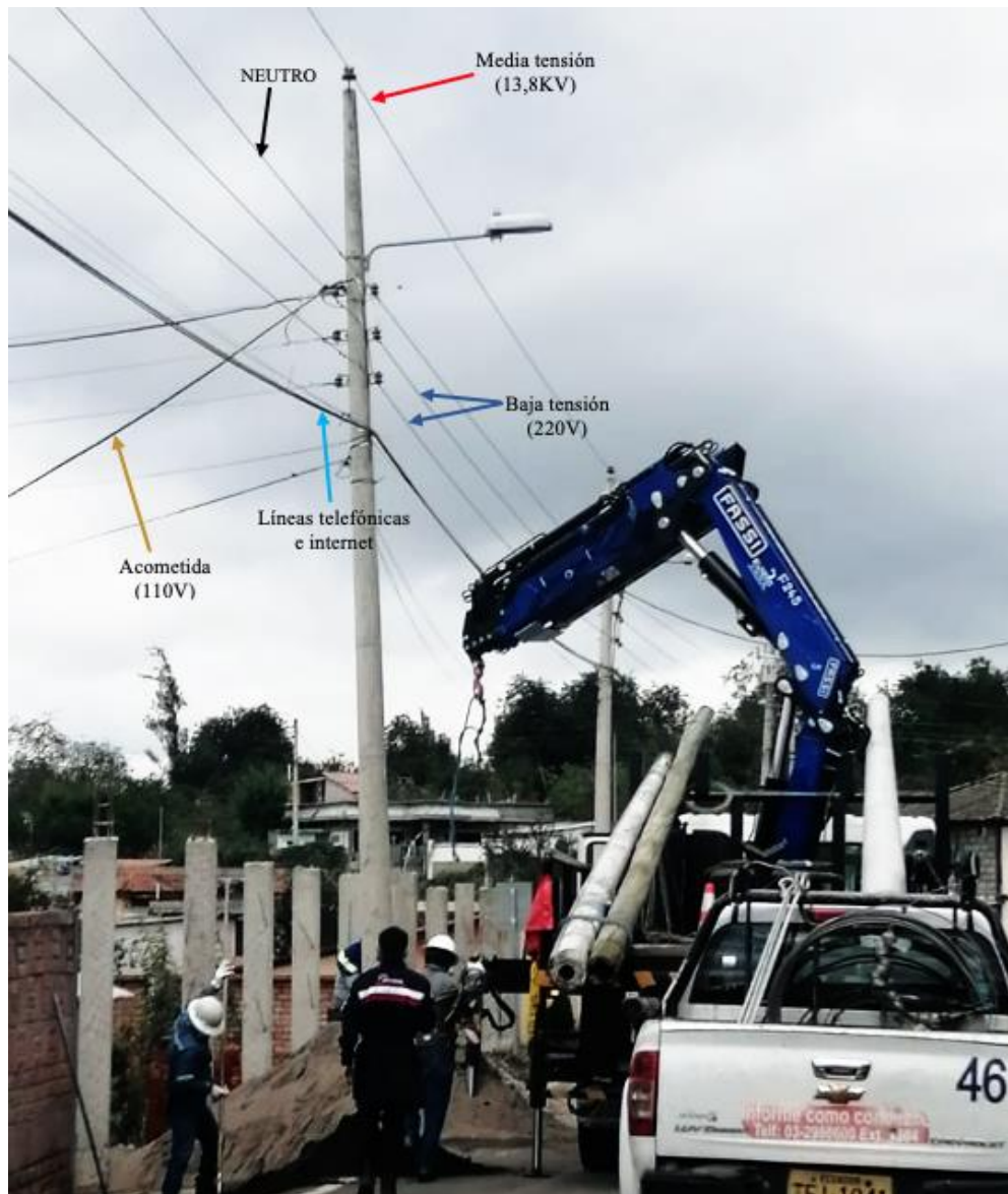
Ilustración 13: Distribución de las líneas eléctricas en los postes de media tensión
