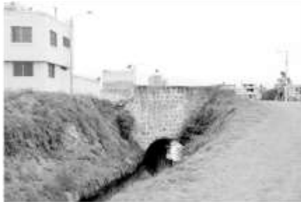
Ladera de canal de gran altura sin barreras de seguridad
