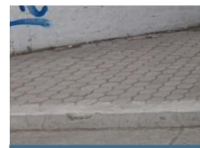
Imagen 24: Estado actual de aceras.
