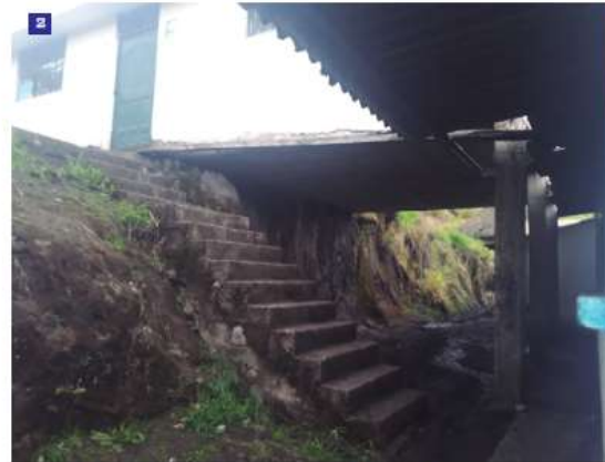
Gradas fundidas de conexión de planta baja hacia la dirección, se observa una estructura soportada por 2 columnas de 20x20cm, aparente carencia de vigas.
