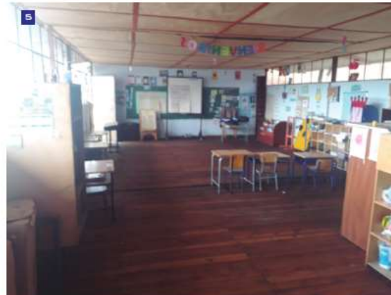
Interior de aula, con mamposterías de ladrillo, estructura metálica, cubierta de fibrocemento, tumbado de madera, piso de entablado, puerta y ventanas de estructura metálica.
