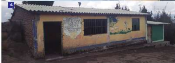
Aula más pequeña abandonada por malas condiciones, estructura de hormigón armado, mamposterías de ladrillo, cubierta de fibrocemento, sin puerta y protectores de ventana, piso de hormigón visto.
