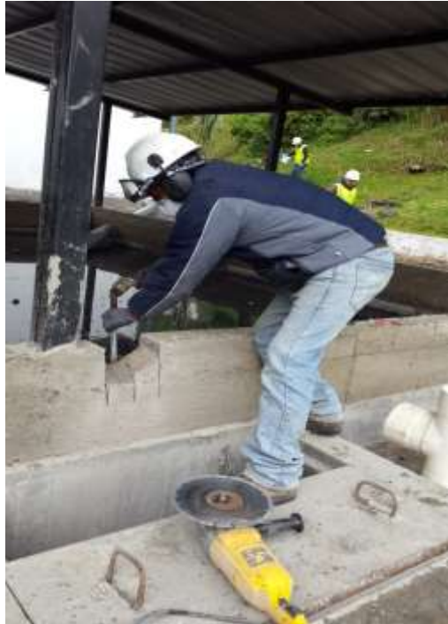
Imagen N°5. Instalación de un rebosadero en el lecho de lodos. Elaborado por: Rosero Alex
