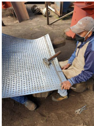
Figura 4: Condiciones de trabajo inadecuadas Fuente: Johnny Reinoso
