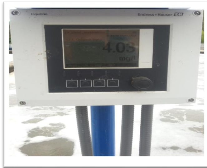
Figura 80: AIT Fuente: PTAR
