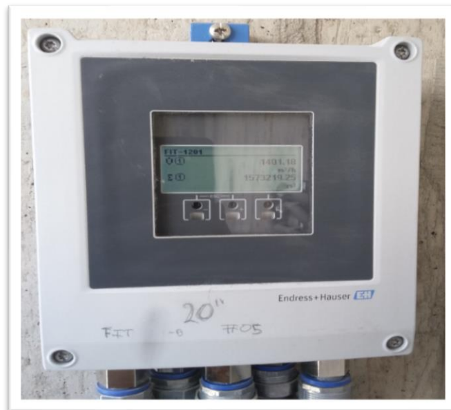
Figura 79: FIT Fuente: PTAR
