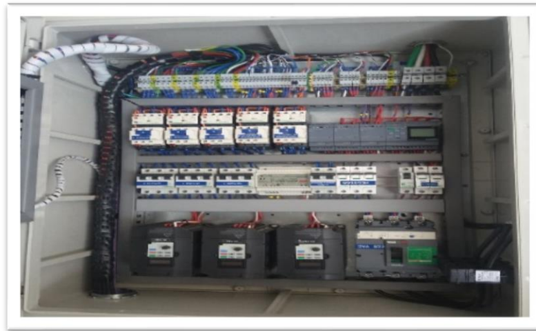
Figura 6: Cuadro de Control de Motores Fuente: PTAR
