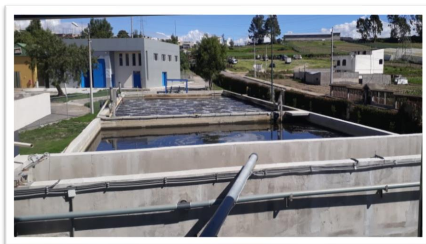
Figura 14: Etapas del Tratamiento Biológico Fuente: Memoria Descriptiva de la PTAR
