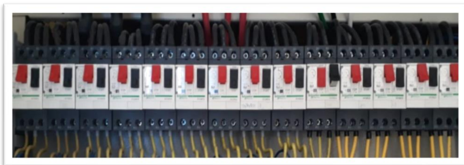
Figura 72: Guardamotor Fuente: PTAR
