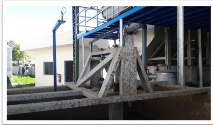
Figura 19: Unidad de Flotación de Fangos Fuente: Memoria Descriptiva de la PTAR
