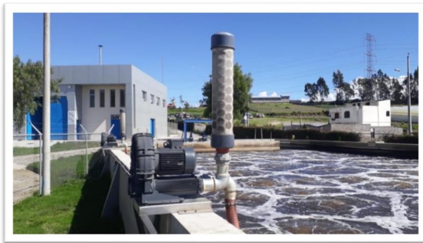
Figura 16: Aireador Fuente: Memoria Descriptiva de la PTAR
