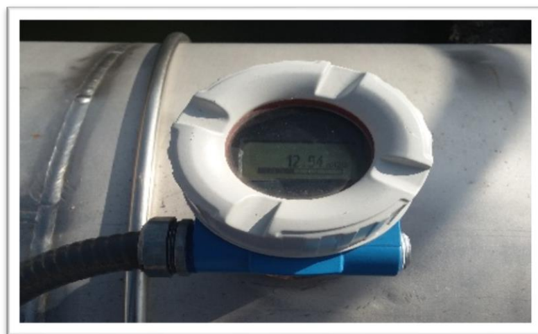
Figura 9: FIT Fuente: PTAR
