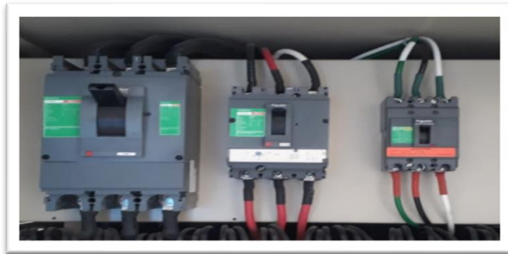
Figura 71: Braker Principal 1Q1 Fuente: PTAR
