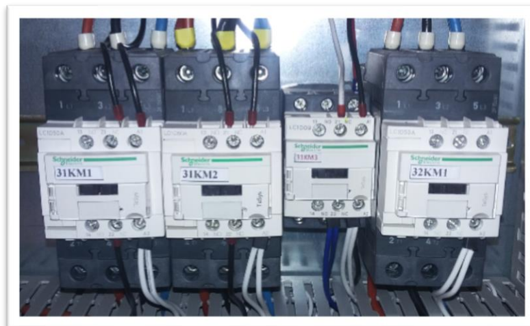
Figura 76: Contactador Fuente: PTAR
