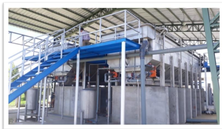
Figura 13: Unidad de Flotación DAF Fuente: Memoria Descriptiva de la PTAR
