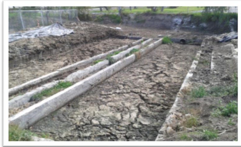
Figura 1: Tanques Imhoff Fuente: Camal Municipal
