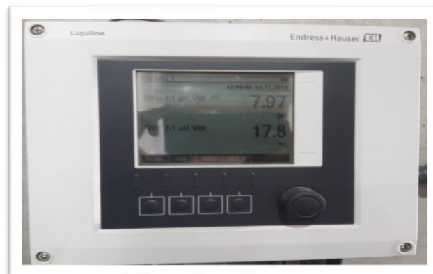
Figura 81: PH Fuente: PTAR
