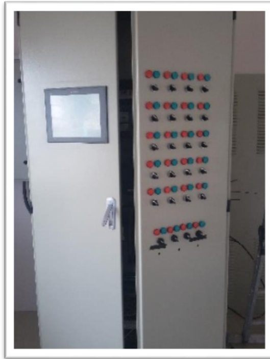
Figura 7: Cuadro de Control de Motores Fuente: PTAR
