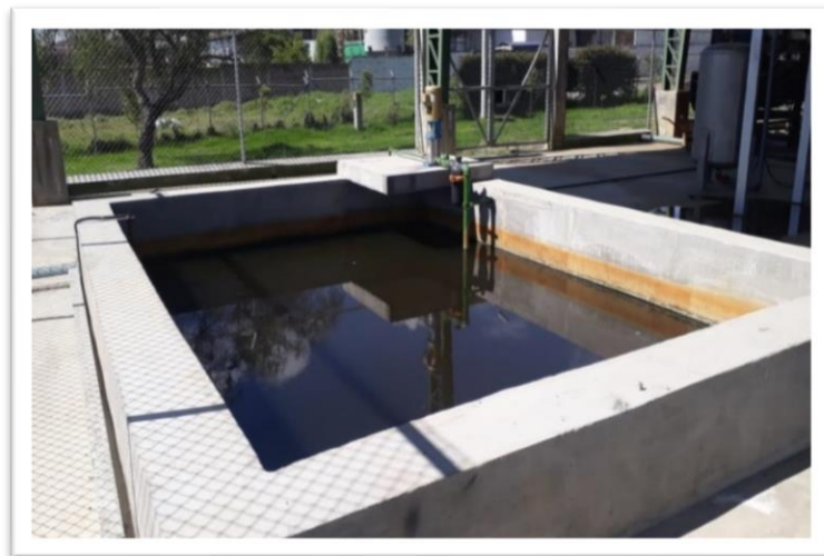
Figura 21: Unidad de Flotación de Fangos
