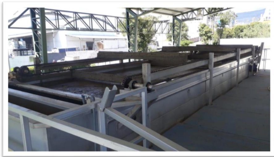
Figura 18: Unidad de Flotación de Fangos Fuente: Memoria Descriptiva de la PTAR
