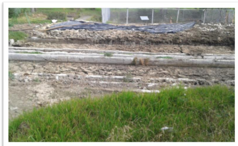
Figura 2: Estado de los Tanques Imhoff Fuente: Camal Municipal
