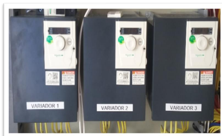
Figura 78: Variador Fuente: PTAR
