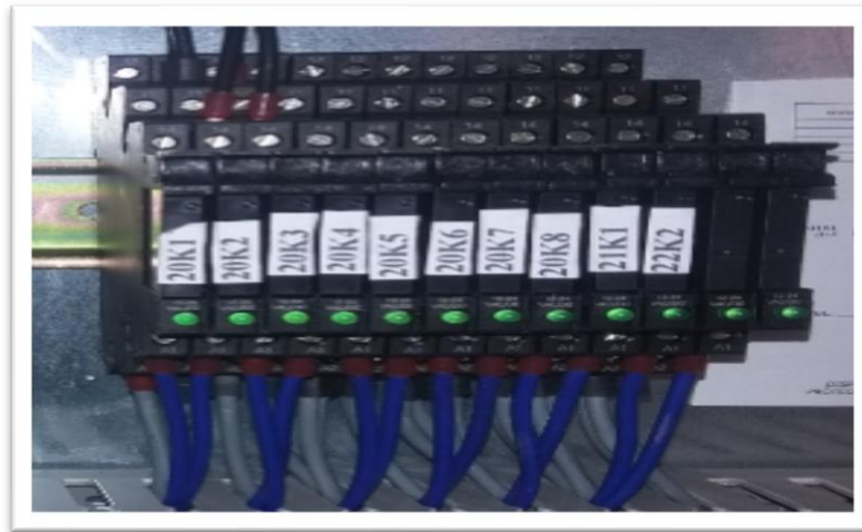
Figura 77: Relé Fuente: PTAR
