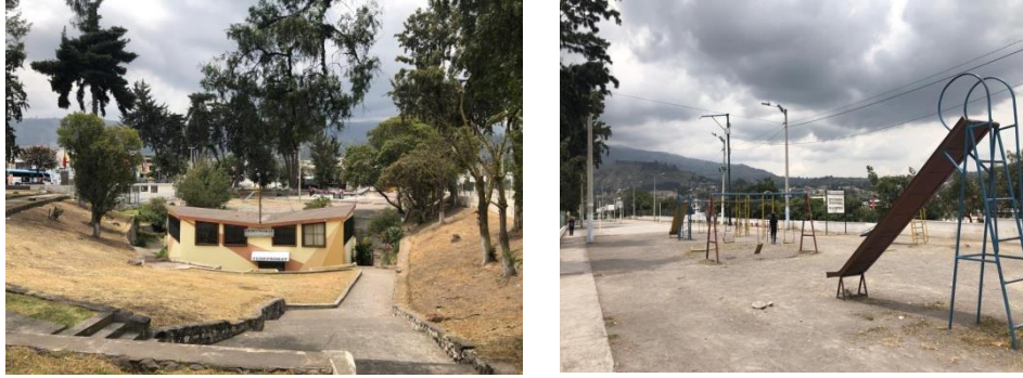
Imagen 13. Deterioro del parque la Laguna
