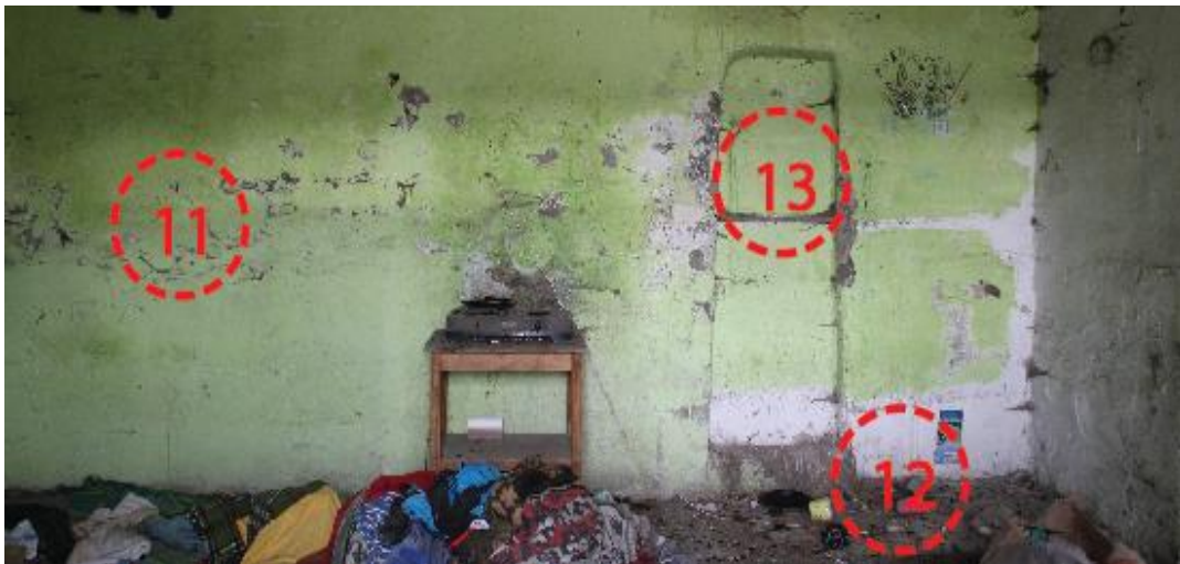
IMAGEN 84: DETERIOROS INTERIOR CELDAS PABELLÓN C
