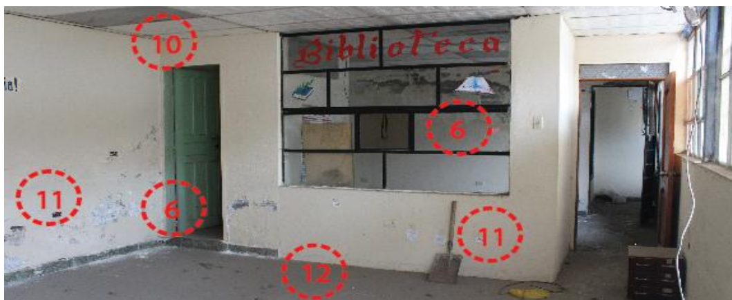
IMAGEN 87: DETERIOROS CELDAS BLOQUE B VARONES
