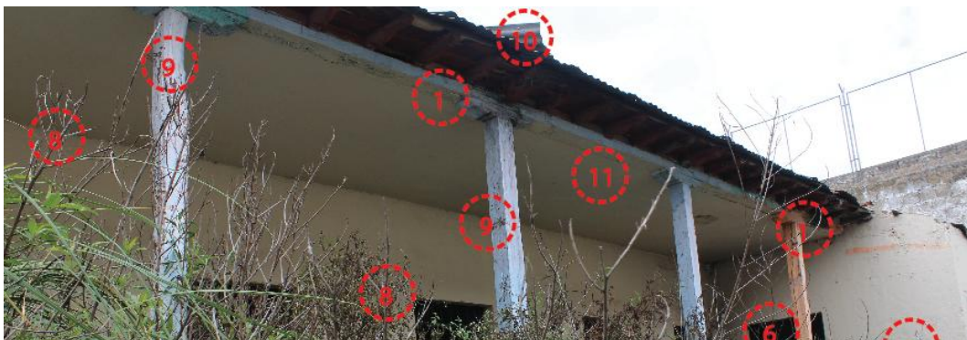
IMAGEN 77: DETERIOROS ELEVACIÓN BLOQUE CELDAS
