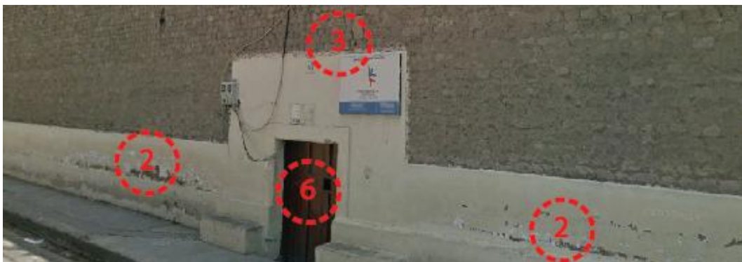
IMAGEN 68: DETERIOROS PABELLÓN OESTE
