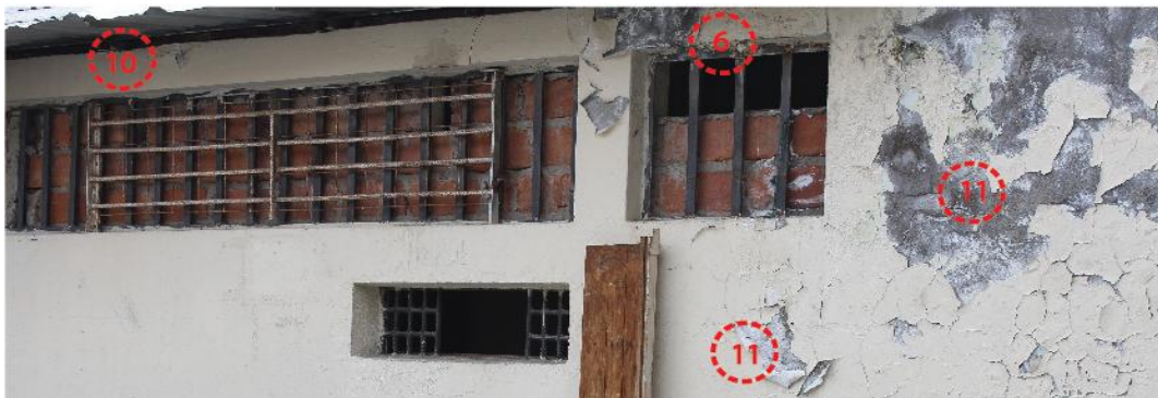
IMAGEN 73: DETERIOROS SECCIÓN CELDAS PABELLÓN B.
