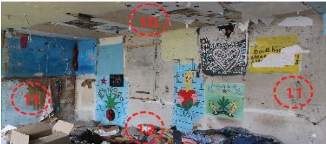
IMAGEN 83: DETERIOROS INTERIOR CELDAS PABELLÓN B
