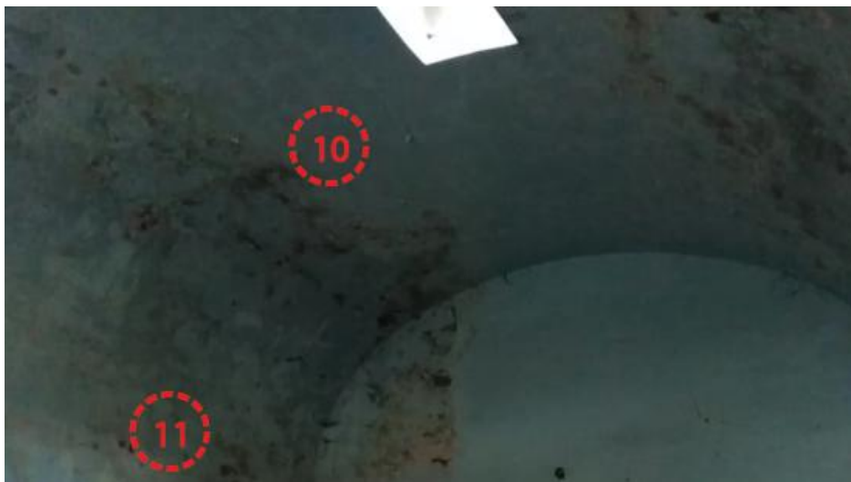
IMAGEN 92: DETERIOROS ELEVACIÓN COCINA
