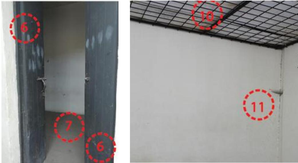
IMAGEN 81: DETERIOROS INTERIOR CELDAS
