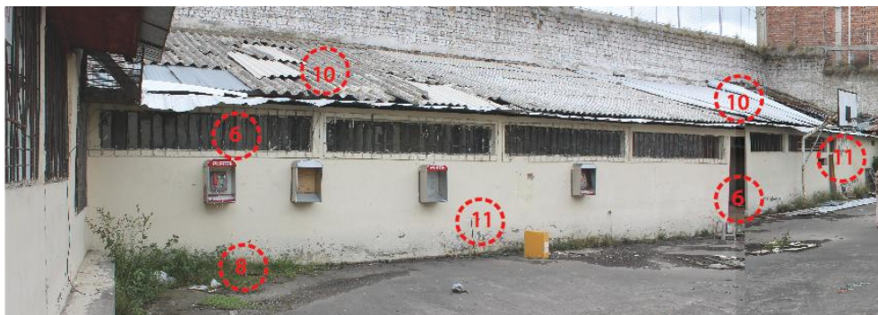
IMAGEN 72: DETERIOROS FACHADA CELDAS PABELLÓN A
