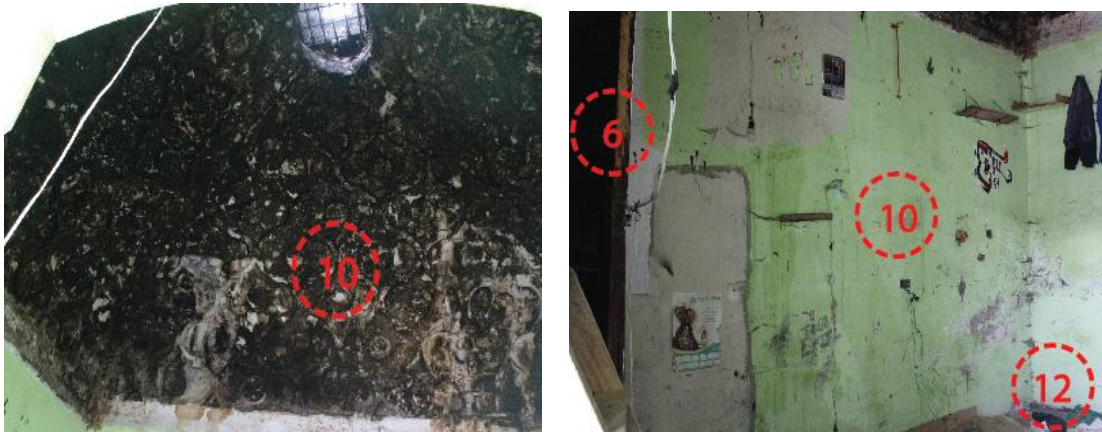
IMAGEN 85: DETERIOROS ELEVACIÓN CELDAS PABELLÓN C
