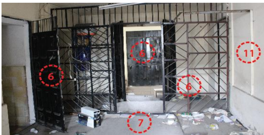
IMAGEN 93: DETERIOROS ÁREA ADMINISTRATIVA INGRESO
