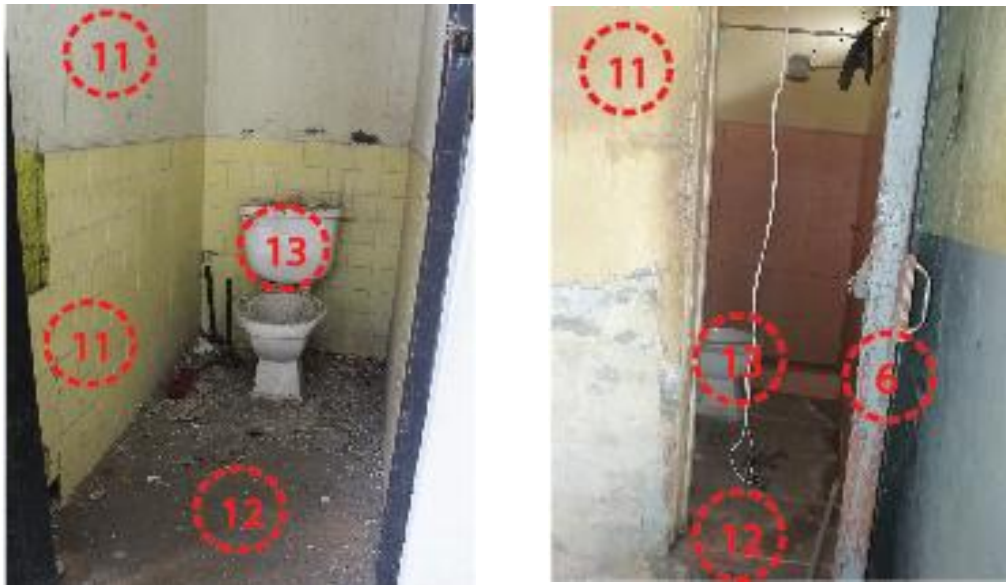
IMAGEN 89: DETERIOROS BLOQUE INTERIOR BATERÍAS SANITARIAS
