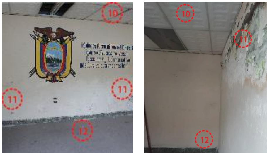
IMAGEN 88: DETERIOROS BLOQUE AULAS
