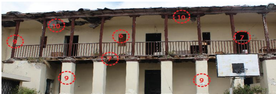
IMAGEN 71: DETERIOROS PABELLÓN CELDAS
