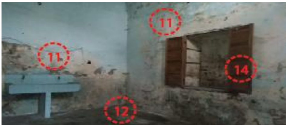
IMAGEN 90: DETERIOROS COCINA LADO A
