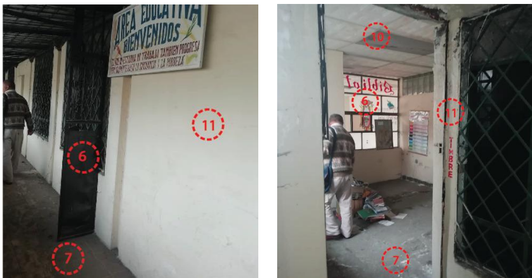
IMAGEN 86: DETERIOROS CELDAS BLOQUE A VARONES
