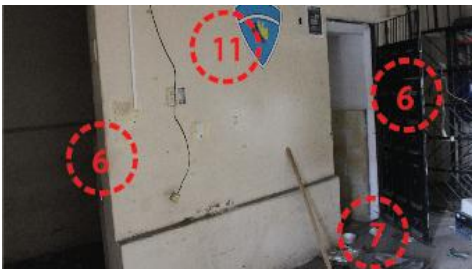
IMAGEN 94: DETERIOROS ÁREA ADMINISTRATIVA LADO A
