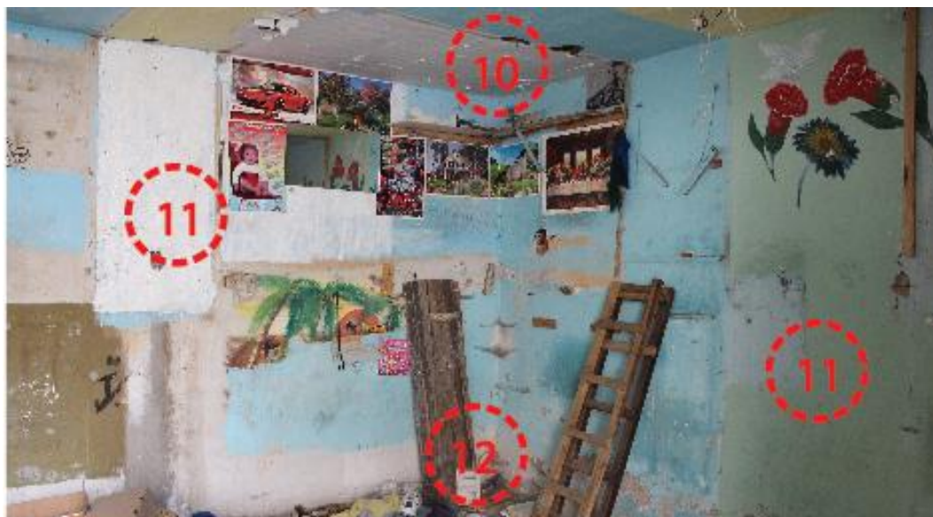
IMAGEN 82: DETERIOROS INTERIOR CELDAS PABELLÓN A
