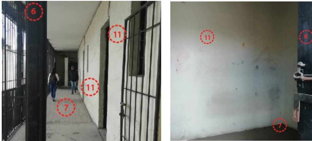
IMAGEN 80: DETERIOROS INTERIOR BLOQUE CELDAS
