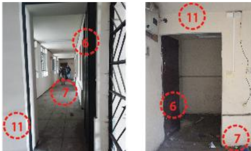
IMAGEN 95: DETERIOROS ÁREA ADMINISTRATIVA LADO B
