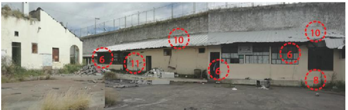
IMAGEN 75: DETERIOROS BLOQUE CELDAS
