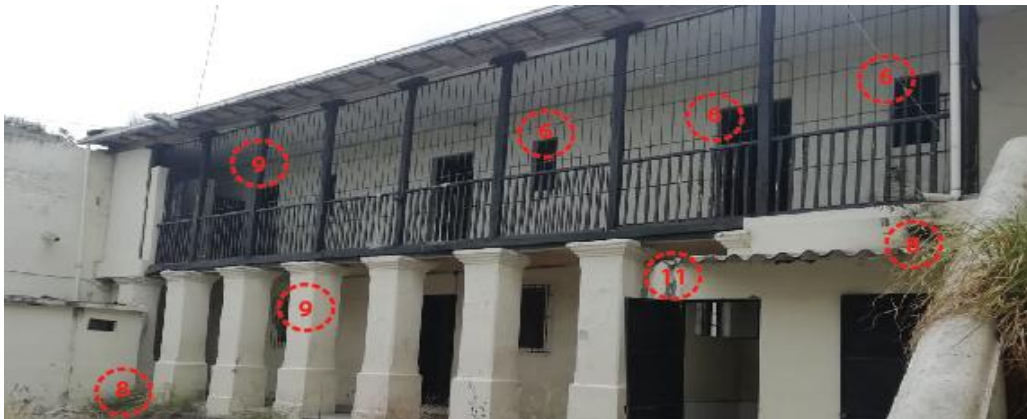
IMAGEN 69: DETERIOROS PABELLÓN DE CELDAS
