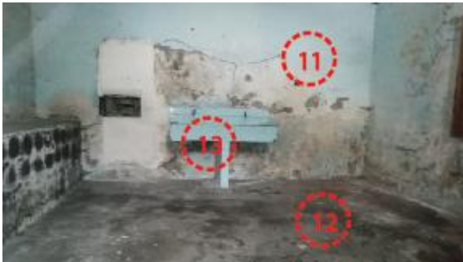
IMAGEN 91: DETERIOROS COCINA LADO B
