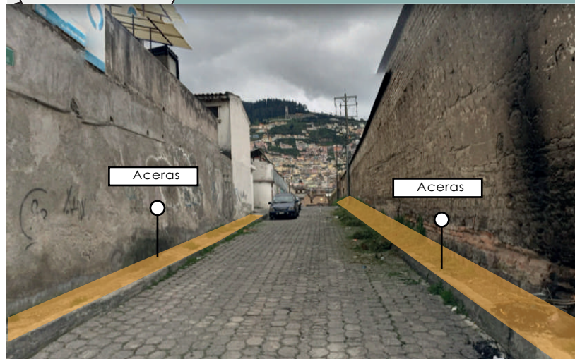
CALLE VILLAVICENCIO 3 Aceras con anchos mínimos para el peatón. las aceras estan en mal estado y no tienen un espacio donde el peatón no puede circular de una manera adecuada.
