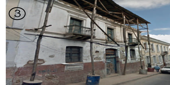
③ Residencia en mal estado
