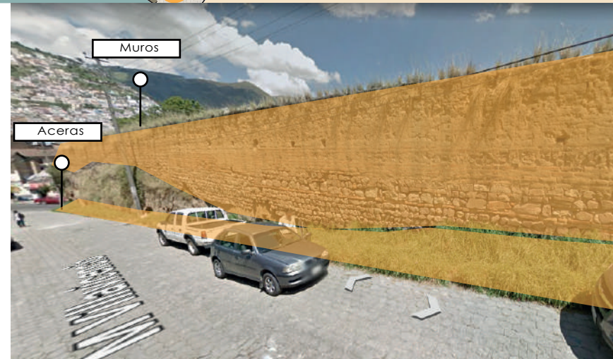
CALLE VILLAVICENCIO 4 Aceras con anchos mínimos para el peatón. Muros de contención en mal estado Los muros de contención estan en mal estado, y no se encuentran aceras en esta parte de la calle Villavicencio.
