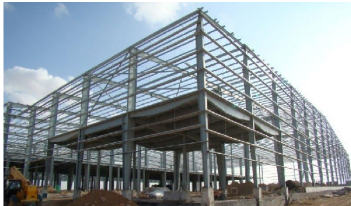
Imagen 25. Elementos estructurales metálicos Fuente: goo.gl/GLa3af
