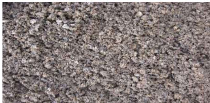
Imagen N. ° 4: Hormigones aligerados a sin agregado fino. Autor: (Abarca, 2018)
