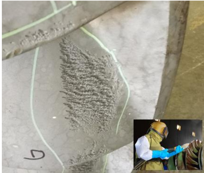
Imagen 5: Desgaste por cavitación en álabes del rodete.
