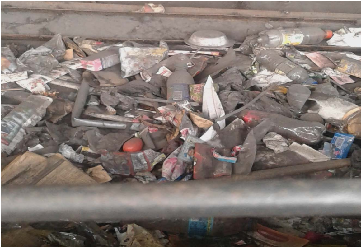
Figura 34. Problemática 1. Acumulación De Basura Dentro Del Inmueble
