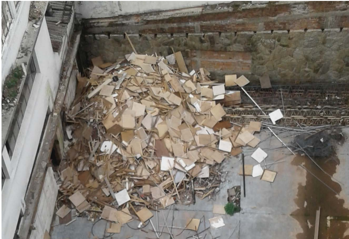
Figura 35. Problemática 2. Acumulación De Escombros Al Interior Del Edificio
