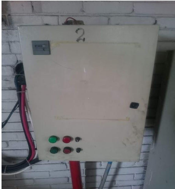
Figura 16. Vista exterior tablero de control sistema motor-bomba N° 2 Fuente: EB. Libertad Baja Elaborado por: Juan Carlos Gancino
