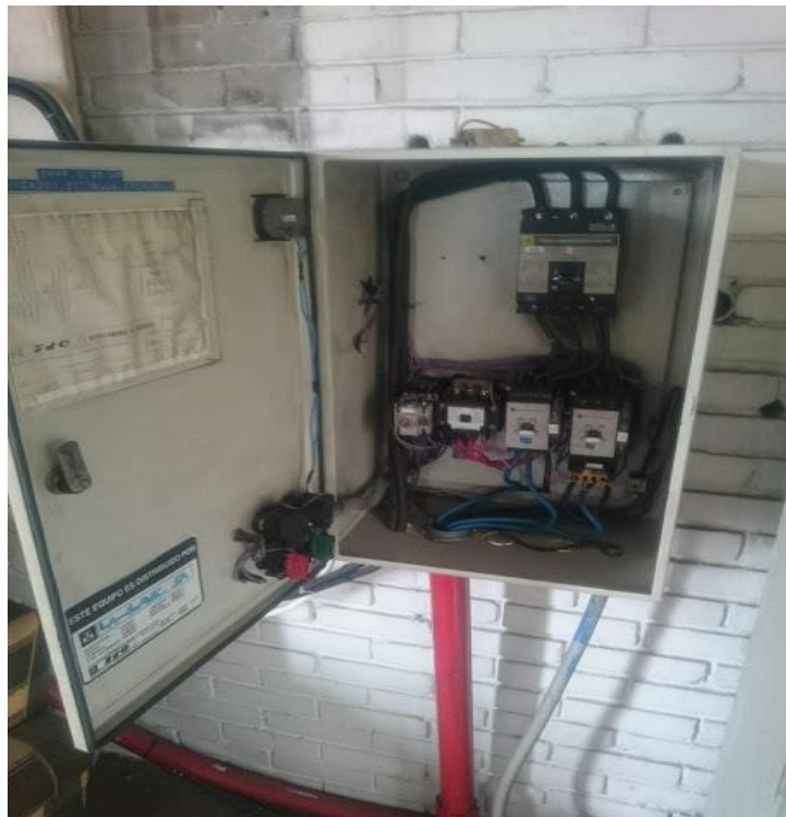
Figura 15. Vista interior tablero de control sistema motor-bomba N° 2 Fuente: EB. Libertad Baja Elaborado por: Juan Carlos Gancino
