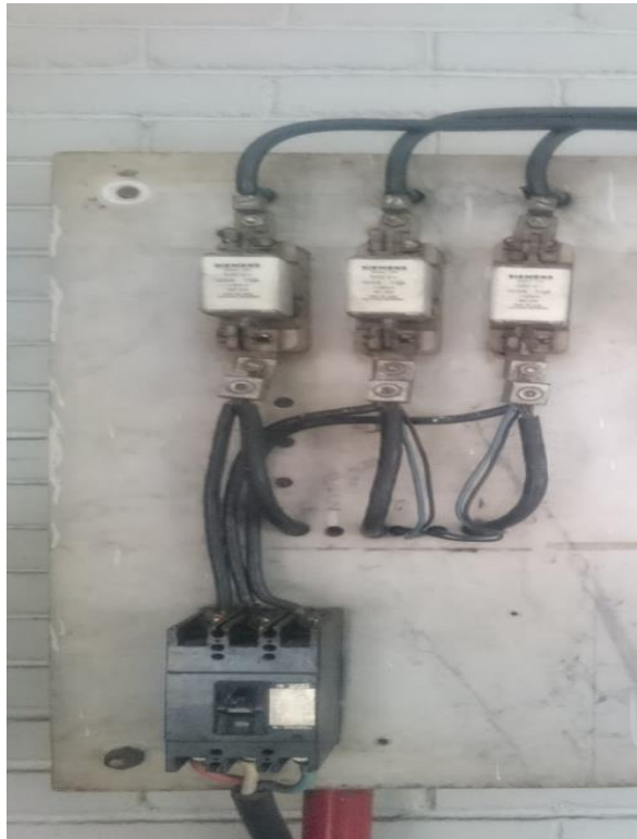
Figura 11. Breaker y fusibles principales sistema motor-bomba N° 1 Fuente: EB. Libertad Baja Elaborado por: Juan Carlos Gancino
