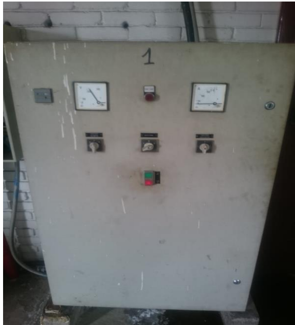
Figura 13. Vista exterior tablero de control sistema motor-bomba N° 1 Fuente: EB. Libertad Baja Elaborado por: Juan Carlos Gancino
