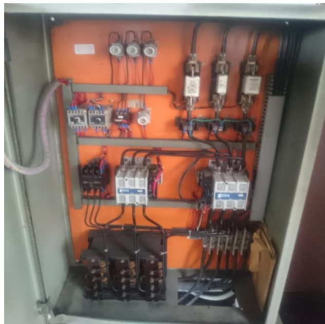
Figura 12. Vista interior tablero de control sistema motor-bomba N° 1 Fuente: EB. Libertad Baja Elaborado por: Juan Carlos Gancino
