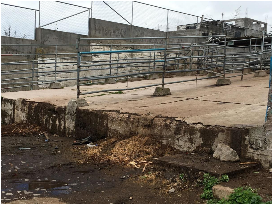
Imagen 26. Mal estado de plataforma de recepción de ganado Elaboración propia
