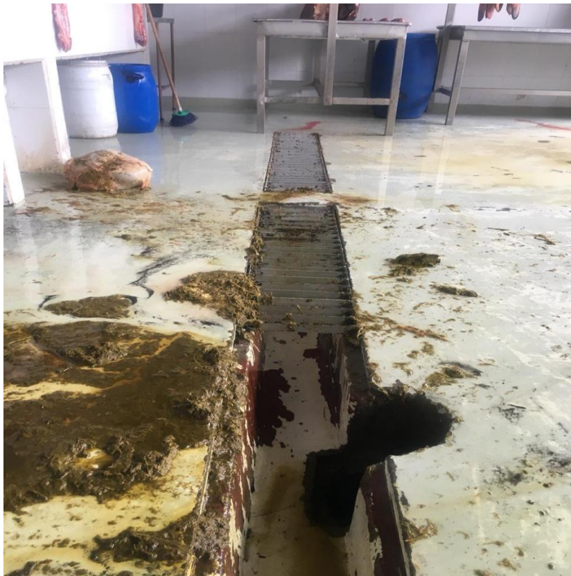
Imagen 12. Abastecimiento insuficiente de pendientes hacia el sumidero Elaboración propia
