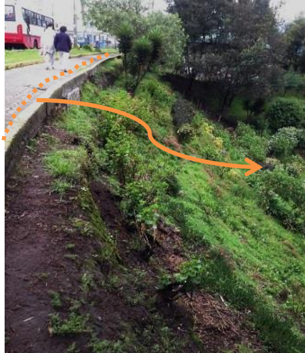
Gráfico 46: Inaccessibilidad del paso peatonal, sector Área verde del tramo de estudio de la quebrada Ortega, barrio solidaridad Quitumbe
