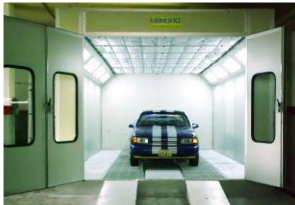
Figura N°3. Horno curado pintura ELPO
