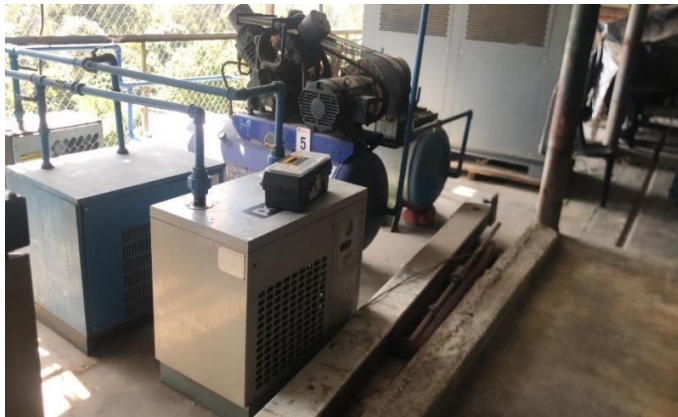
Figura 10 Área de los compresores
