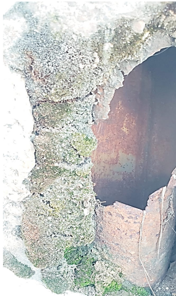
Figura 57 Crecimiento Biológico en bajantes de agua lluvia.
