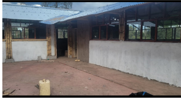
Figura 88. Detalle de pintura en paredes exteriores
