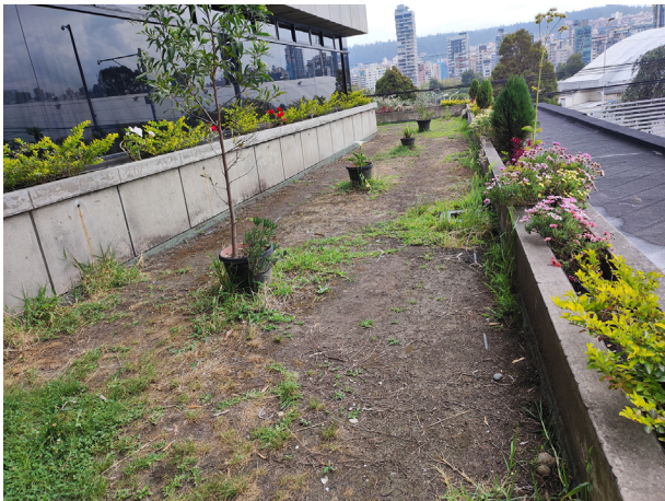
Figura 70. Césped en mal estado por falta de mantenimiento. Fuente: Elaboración propia, 2023.
