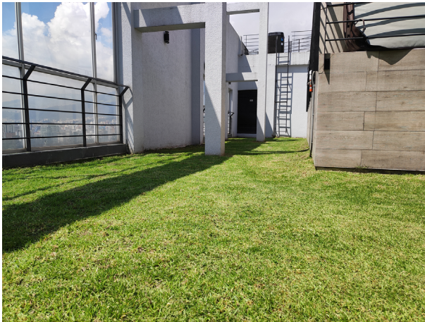
Figura 78. Cubierta verde a manera de tapizante. Fuente: Elaboración propia, 2023.
