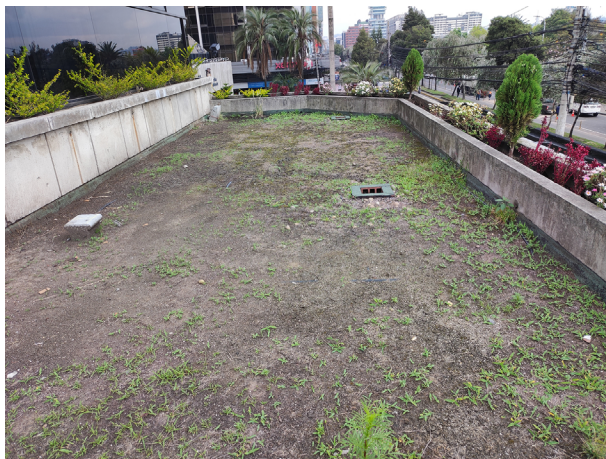
Figura 68. Cubierta verde en mal estado. Fuente: Elaboración propia, 2023
