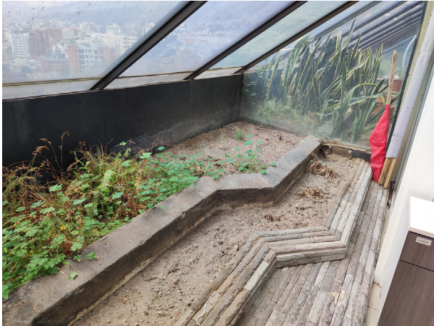
Figura 69. Deterioro en el jardín Fuente: Elaboración propia, 2023.
