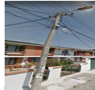
Tipo: Luminaria Simple Materialidad: Concreto Tamaño: h= 8 m
