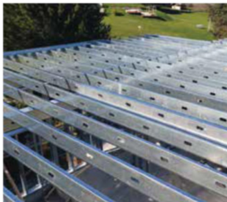
Figura 15 estructura entrepisos de steel framing Fuente: Disser, Distribución y servicios para la construcción.
