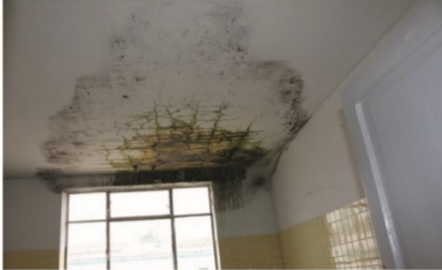
Descripción: Los cielorasos del inmueble están afectados por la humedad.
