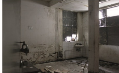
Descripción: Al interior del inmueble se puede observar el deterioro acelerado al que está sujeto el inmueble.
