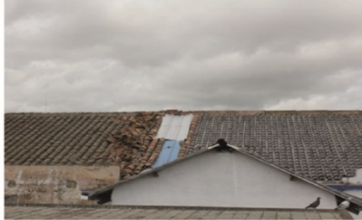
Descripción: Detalle de la cubierta y su evidente deterioro.
