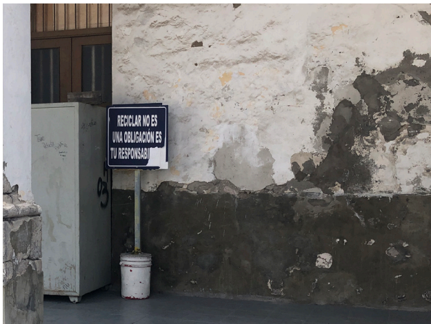
Figura 20 Patologías en Instituto Superior Vicente León
