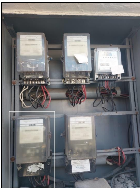
Figura 4: Medidor eléctrico de la Heladería Piwy's
