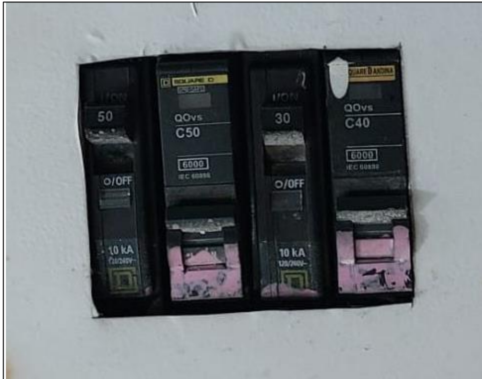
Figura 5: Panel de distribución de la Heladería Piwy's
