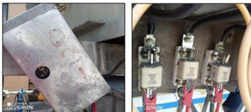
Figura 20. Instalación del analizador de redes eléctricas en el transformador de la organización
