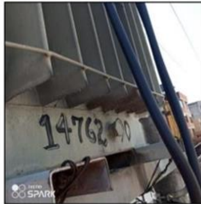
Figura 16. Transformador trifásico de 90 kVA de la instalación
