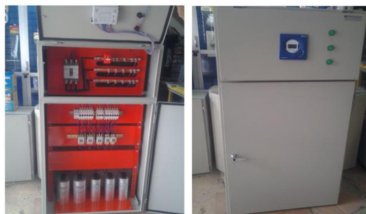
Figura 39. Banco de condensadores a implementar
