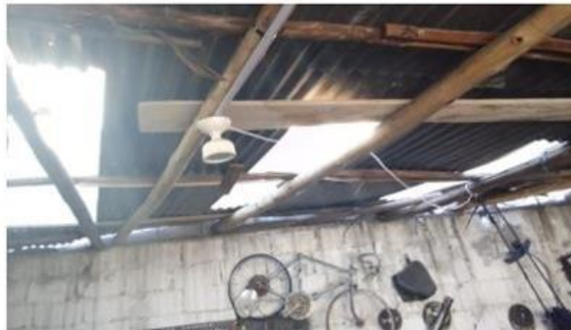
Figura 18. Lámparas de las instalaciones
