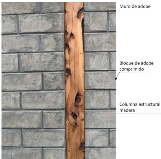
Imagen 26. Fotografía muro de adobe comprimido (Geablocks) y columna de madera del estudio GEARTH. Fuente: Elaboración propia, 2022.
