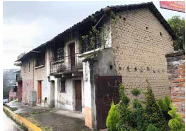
Fig 2: Vivienda tradicional deteriorada en Amaguaña Fuente: Autor
