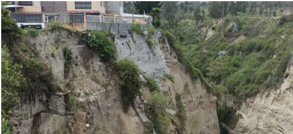
Figura 4 Asentamientos en quebradas de Quito
