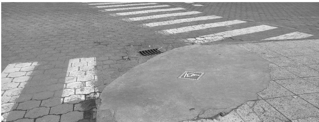
Figura 20. Fotografía de vados que incumplen la normativa y sus especificaciones técnicas Fotografía de vados que incumplen la normativa y sus especificaciones técnicas
