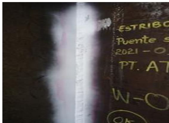
Imagen 105: Inspección de refuerzos externos Elaborado por: Moreno, Wilson (2022)
