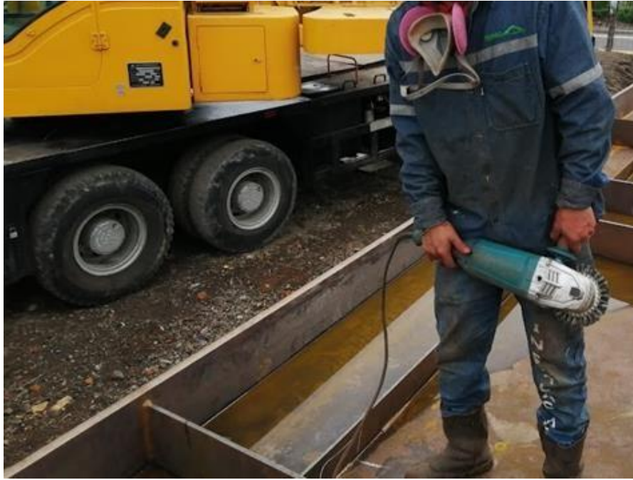
Imagen 102: Inspección de arrostramiento Elaborado por: Moreno, Wilson (2022)
