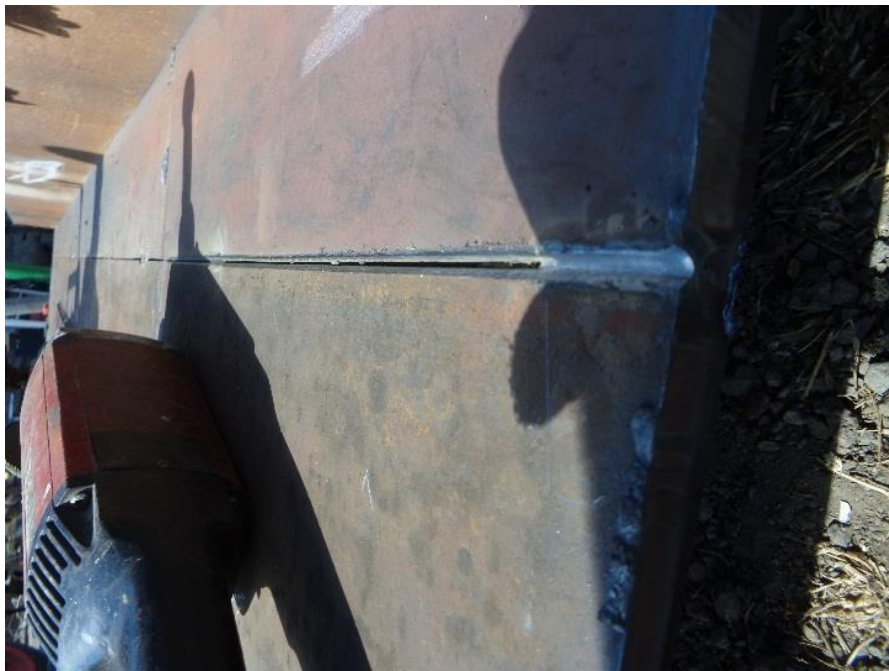
Imagen 34: Procedimientos de biselado de planchas de acuerdo a la normativa AWS D1.1 Elaborado por: Moreno, Wilson (2022)
