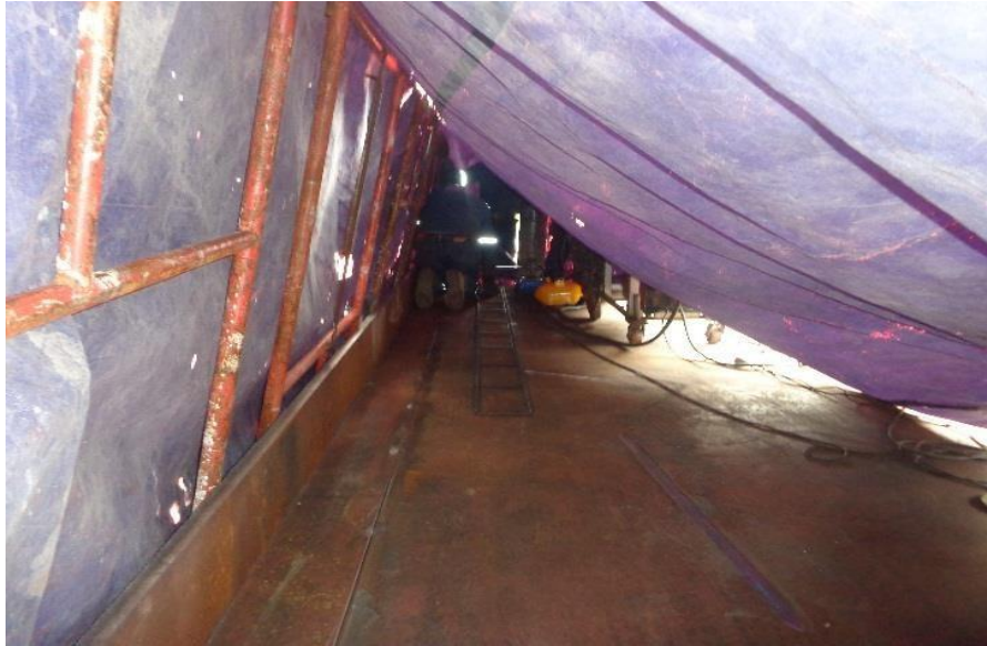
Imagen 37: Protección con caseta para evitar discontinuidades y contaminación atmosférica Elaborado por: Moreno, Wilson (2022)
