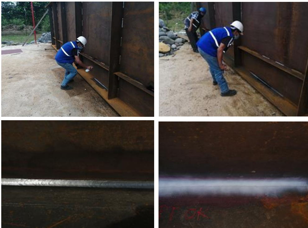
Imagen 101: Inspección de patín, alma Elaborado por: Moreno, Wilson (2022)
