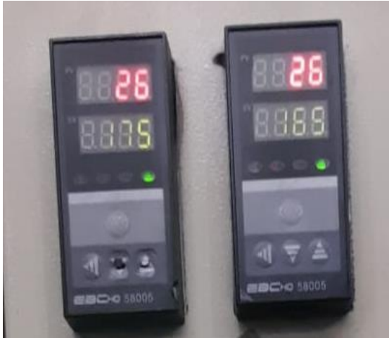
Imagen 19 Controladores de temperatura
