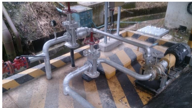
Figura 24 Bomba tanque de alivio.
