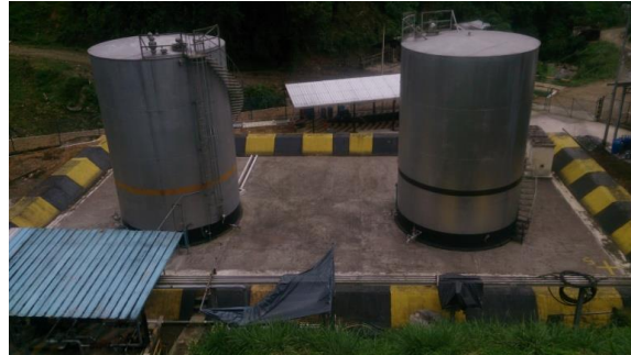
Figura 21 Tanque de alivio y tanque de almacenamiento Estación Faisanes Elaborado por: César Ríos
