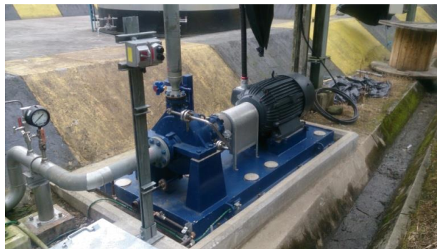
Figura 25 Bomba tanque de alivio (nueva)
