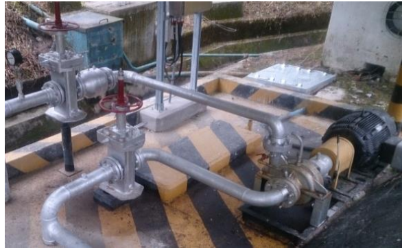
Figura 57 Bomba tanque de refuerzo
