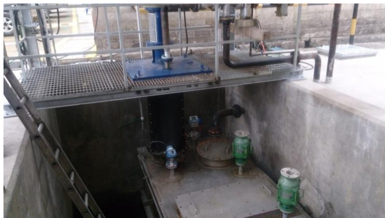
Figura 22 Tanque sumidero - Estación Faisanes Elaborado por: César Ríos
