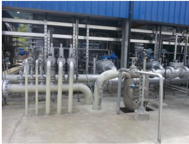
Figura 18 Válvulas de seguridad principales – Estación Faisanes.
