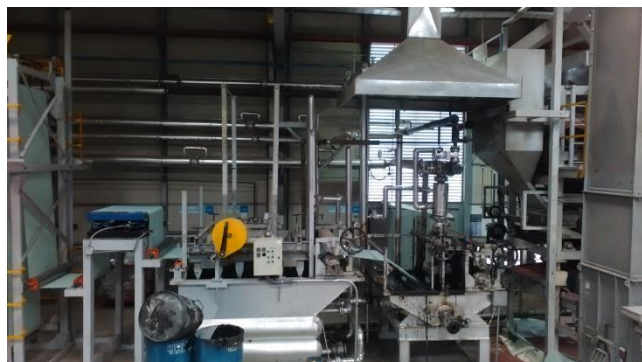
Figura 47: Área despacho de mástico Línea de laminación N° 1
