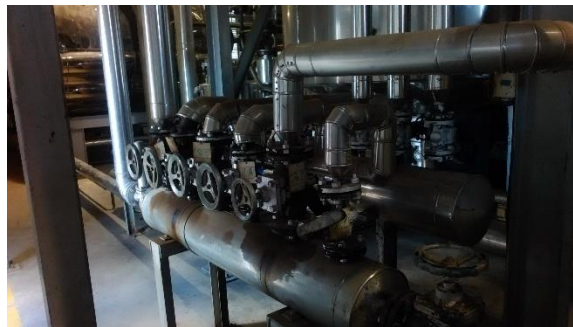
Figura 26: Válvulas de control manual de temperatura (aceite térmico)
