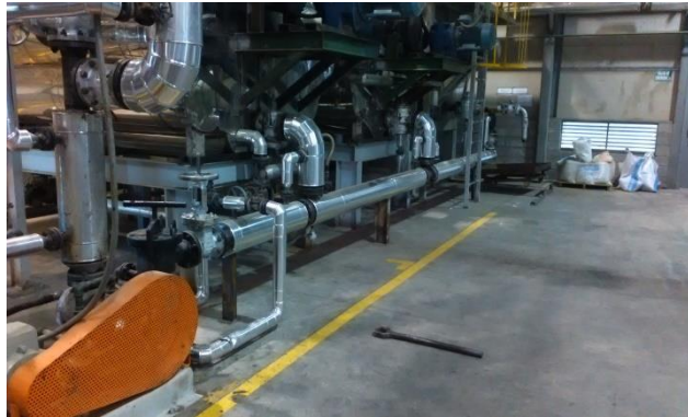
Figura 48: Área bomba de mástico Línea de laminación N° 2
