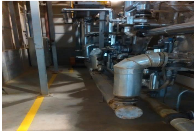
Figura 46: Área bomba de mástico Línea de laminación N° 1
