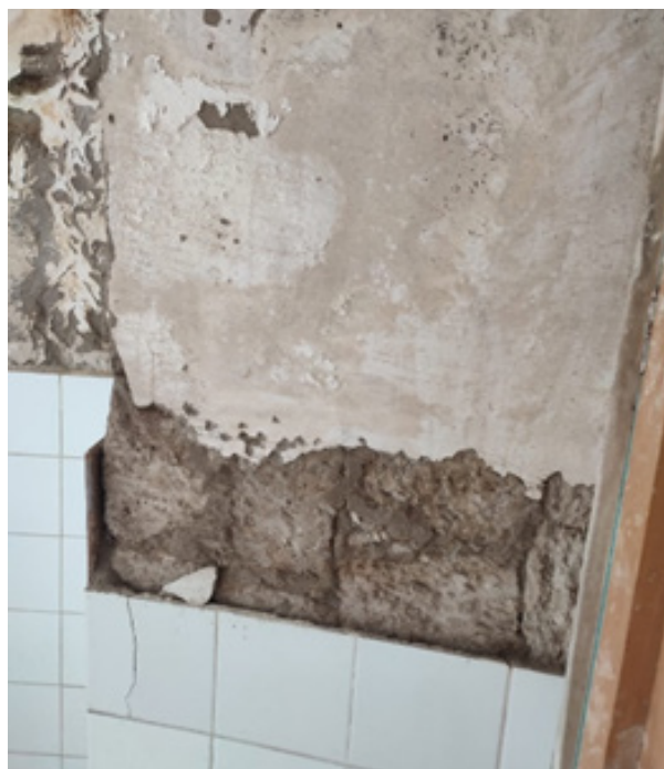
Pared con patología
