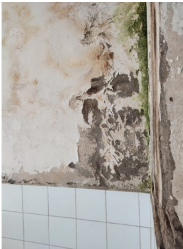
Figura 9 Paredes en descuido
