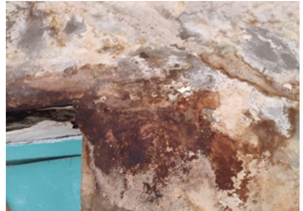
Erosión en paredes
