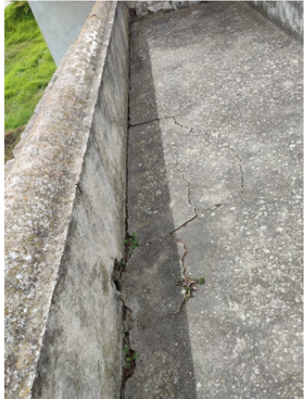
Patología en suelos
