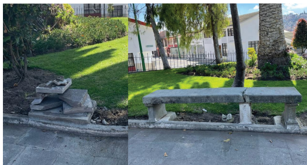
Figura 42 Deterioro y diseño de bancas tipo B1
